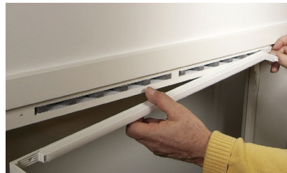
Ilmanottokanavat suodatinkehiksen takana
